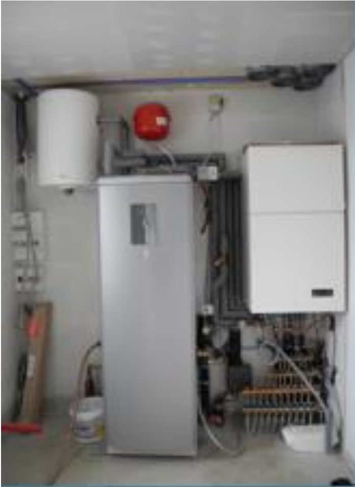
Figur 9. Varmepumpeinstallation i Silkeborg.
